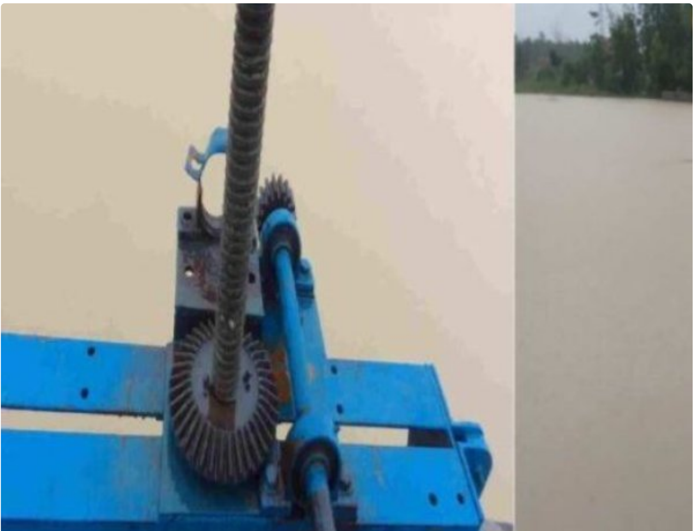
Pintu air Albaret Simpang Mesuji
